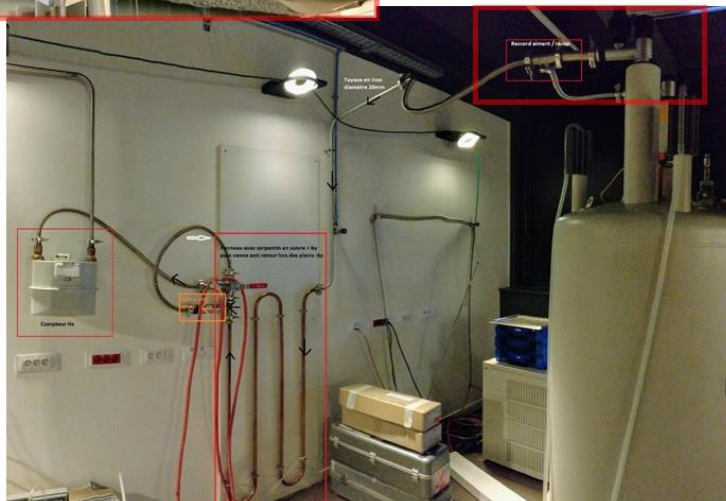
Figure 7: Accessoires permettant le raccordement des aimants supraconducteurs au réseau de récupération
